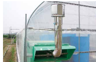
■外気吸入ダクト
